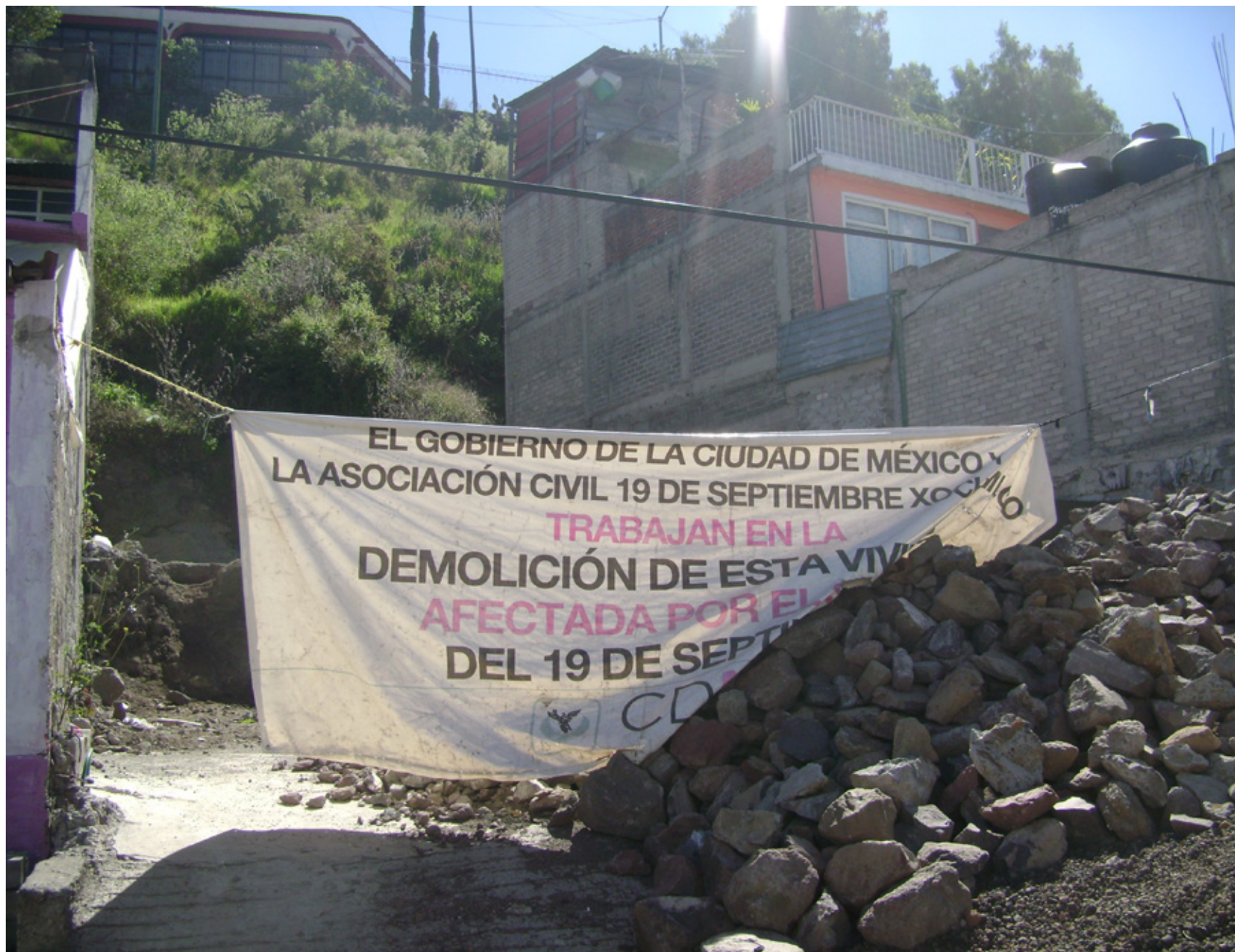
Vivienda afectada por el sismo del 19 de septiembre del 2017. Ubicada a unos pasos del Deportivo de San Gregorio Atlapulco Fotografía: Taller Capital
