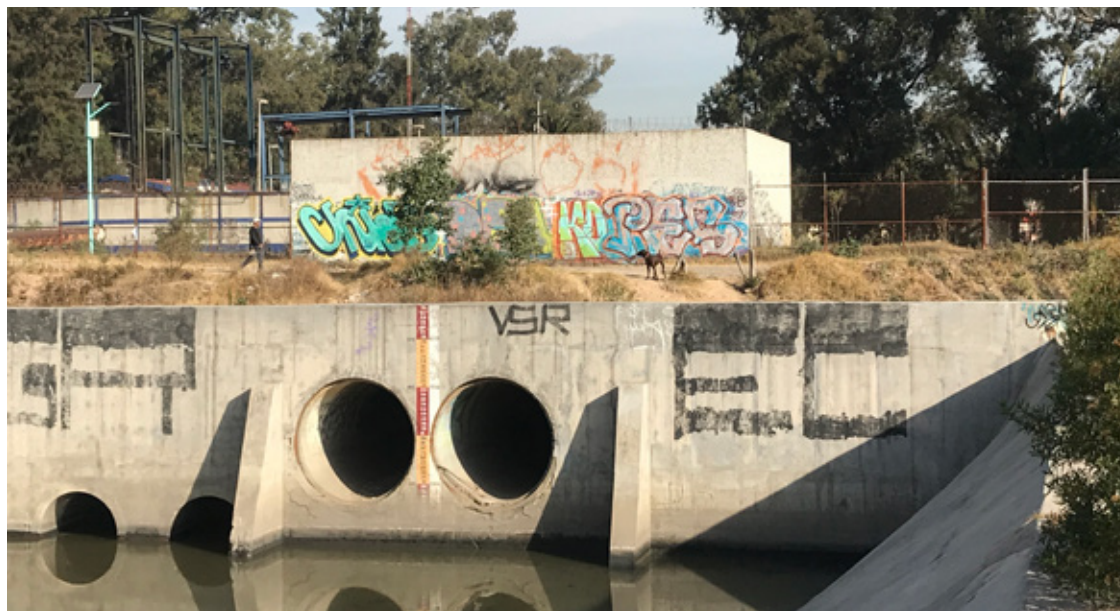
Colector de drenaje, Canal Nacional
