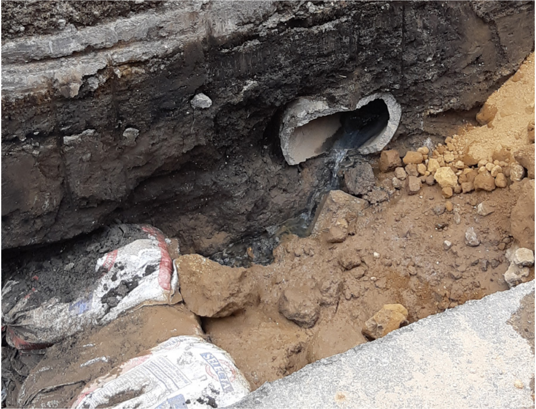
Fracturas en el drenaje en Canal Nacional
