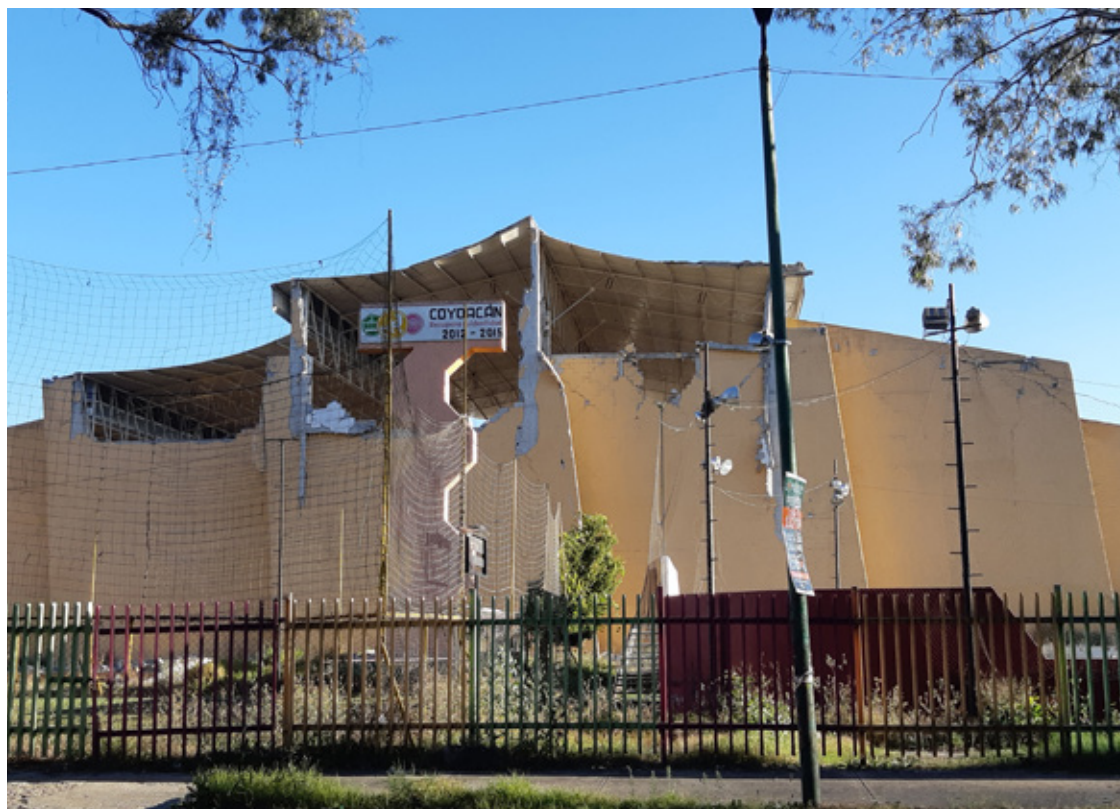
Alberca del Parque Deportivo Francisco J. Mújica dañada por el sismo del 19S-2017, fotografía de diciembre de 2018
