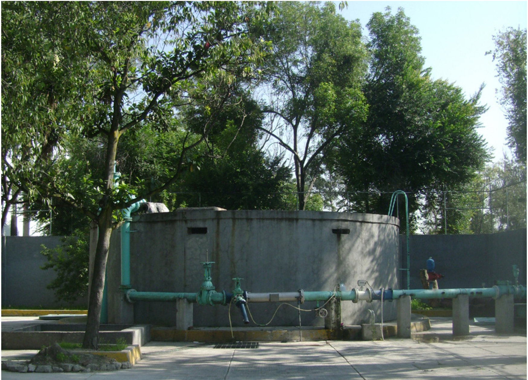
Pozo de extracción en Álvaro Obregón
