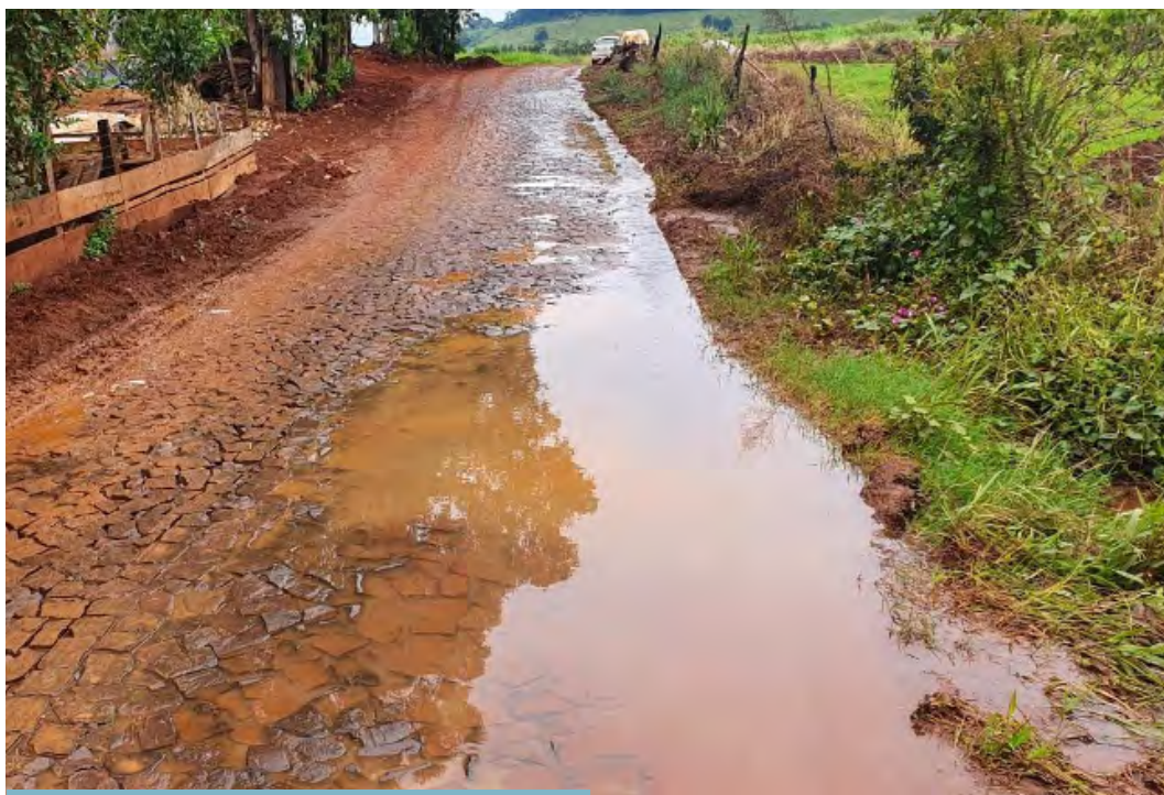
Figura 11. Drenaje inadecuado y plataforma estrecha
