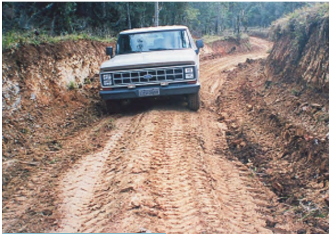
Figura 9. Problemas en la plataforma encajada
