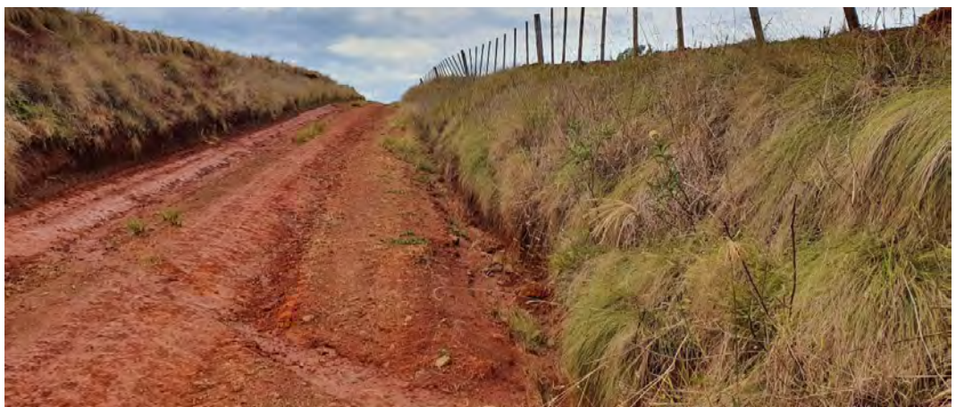
Figura 20. Sistema de drenaje superficial inadecuado
