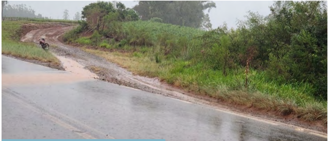
Figura 19. Sistema de drenaje superficial inexistente
