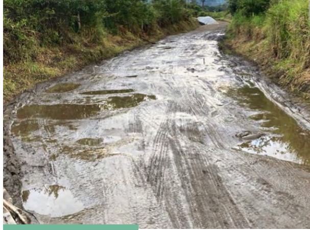
B. Camino en tierra con insuficientes y deficientes elementos de drenaje superficial (Colombia)
