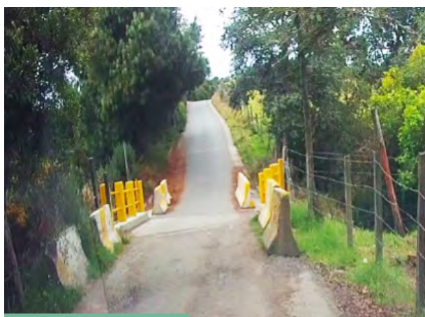
A. Pontón en estructura de hormigón, barandas metálicas y barreras rígidas que generan riesgos
