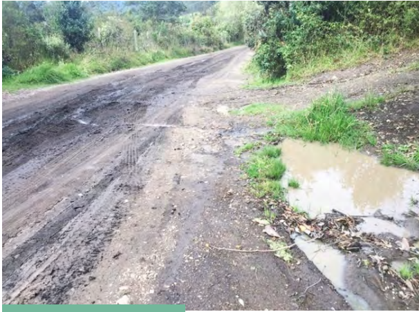
A. Pasacuneta colmatado en vía de acceso a predio privado ocasiona 100 m de daños en la calzada
