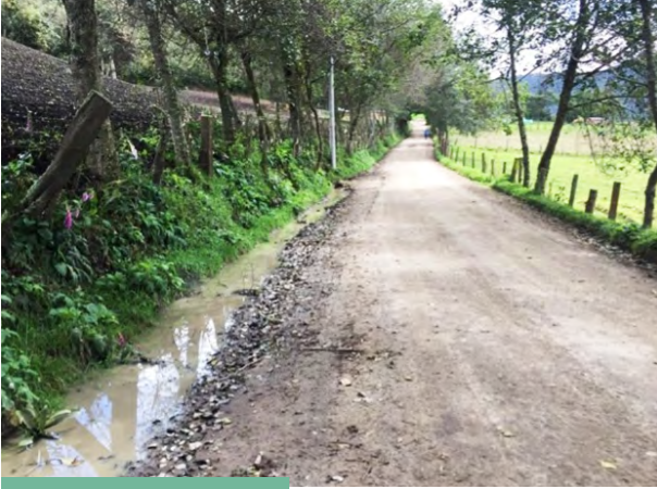
A. Camino en material granular con sección transversal que facilita el drenaje superficial. Acumulación de agua en cuneta por colmatación parcial de alcantarilla (Colombia)
