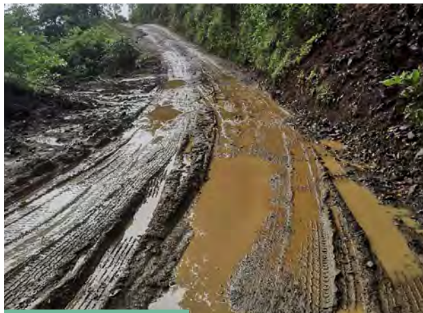
D. Camino en tierra con acumulación de agua por deficiencias del drenaje (Colombia)
