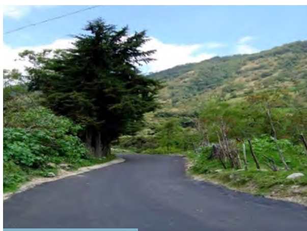
B. Sobre capa de material estabilizado con cal en Tona, Santander (Colombia)
