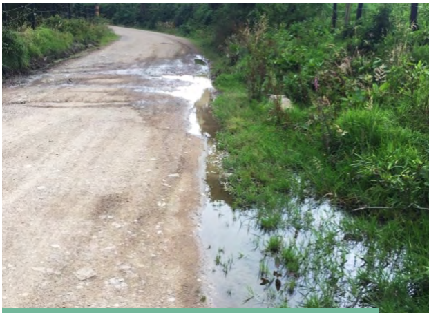
C. Alcantarillas colmatadas que generan acumulación de agua y daños en la calzada
