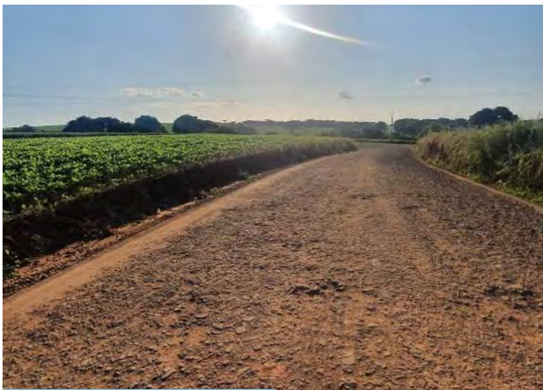
Figura 17. Perda de agregados
