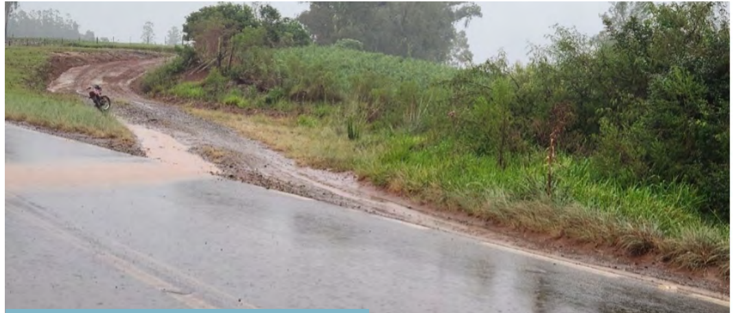
Figura 19. Sistema de drenagem superficial inexistente
