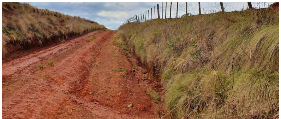
Figura 20. Sistema de drenagem superficial inadequado
