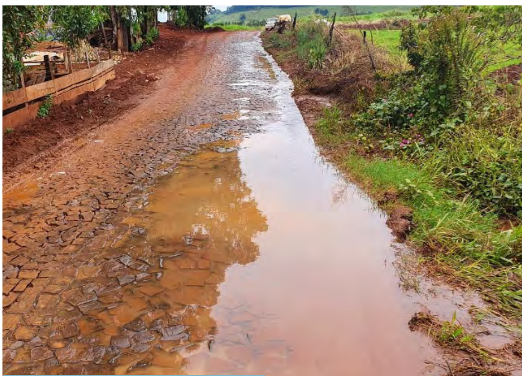
Figura 11. Drenagem inadequada e plataforma estreita
